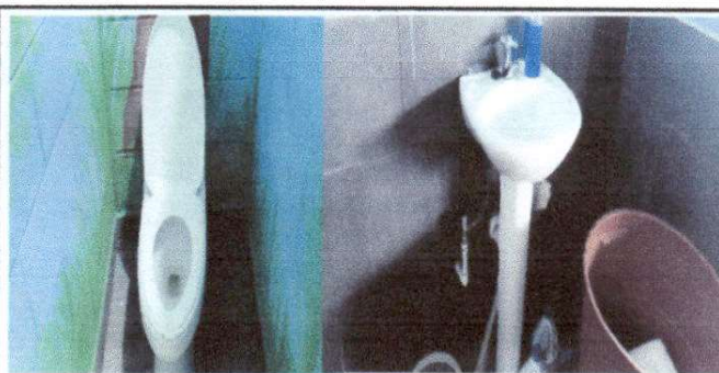
Foto 5. Servicios Sanitarios y sus accesorios
